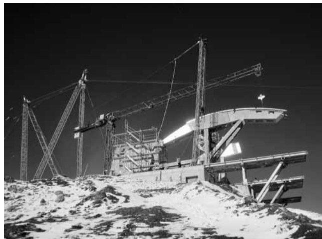
5. November: Bergstation der Urdenbahn auf dem Urdenfürggli
